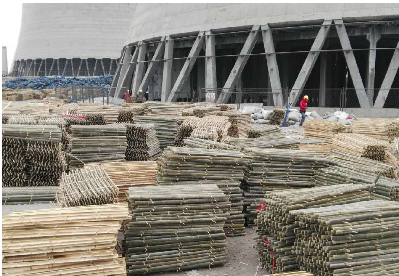
Installation du packing en grilles de bambou à la centrale électrique de Dongfeng, l'une des 80 entreprises en Chine à utiliser cet équipement. Crédit : Ma Xinxin et al.
