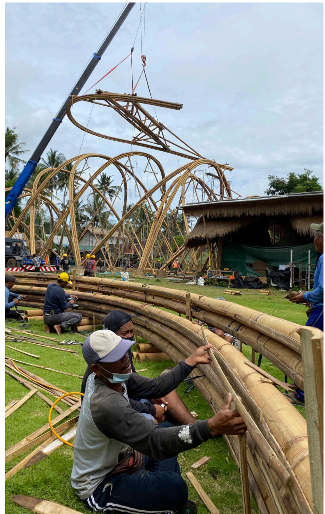
Una grúa levanta un arco para colocarlo en la posición de la estructura de El Arco en la Green School en Bali. Crédito: Elora Hardy.
