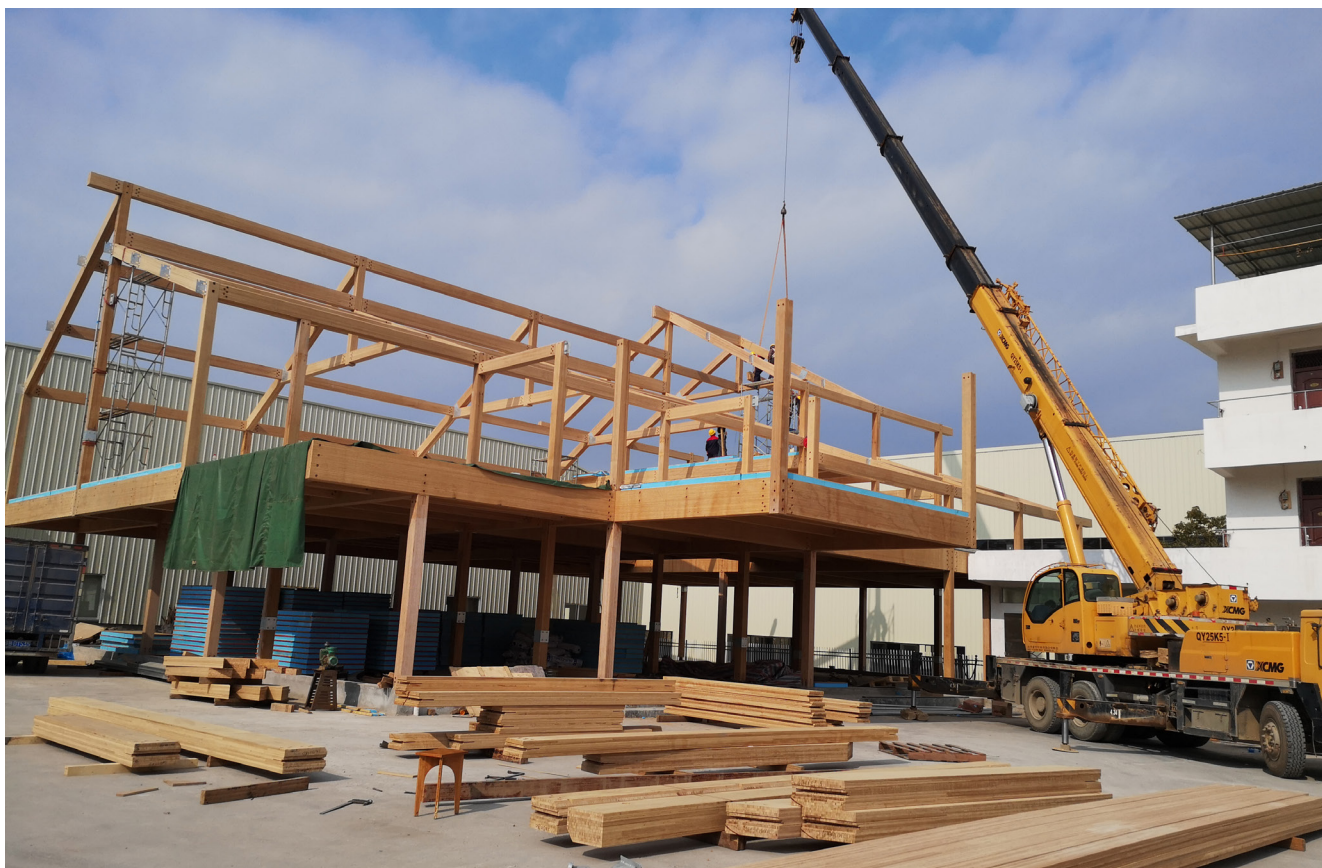
Construcción de un edificio de dos plantas con bambú laminado en China. El bambú ha sido tradicionalmente una elección de material de construcción de viviendas en China durante milenios, pero las nuevas construcciones están ampliando sus aplicaciones y durabilidad. Crédito: Ganzhou Sentai Bamboo & Wood Co., Ltd.
