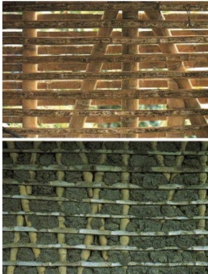
Figure 11: Mur en bambou : structure supérieure en bambou, structure inférieure remplie de mortier
