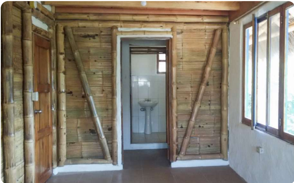
Ilustración 5. Vista de parales de bambú GaK en fachada de vivienda. Fuente: Manabí Bambú, 2020.
