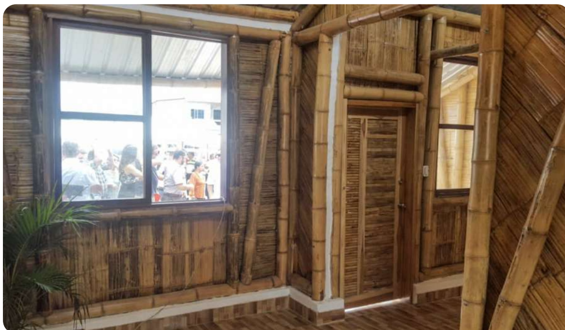
Paredes de bambú columnas simples, marcos de puertas y ventanas de la vivienda BIOCLIMÁTICA
