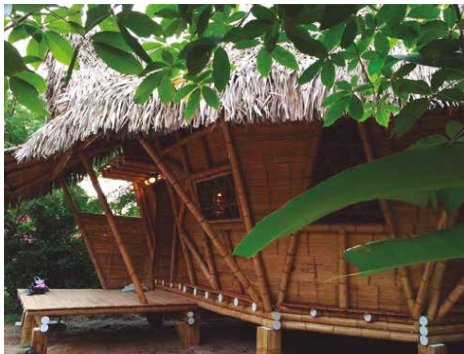
Foto 1. Separación del piso.
