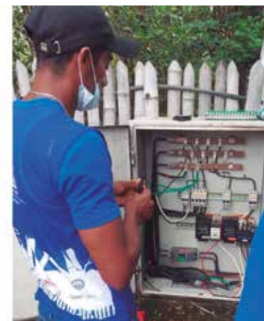
Foto 26. Caja de electricidad.
